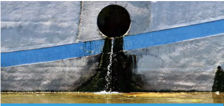
排口与管道监测
