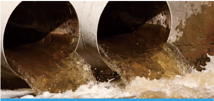
排水管网流量监测
