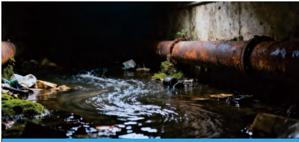
排水管网水质监测
